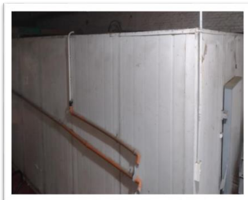
Ilustración 37: cámara de frío. Fuente. Elaboración propia.
