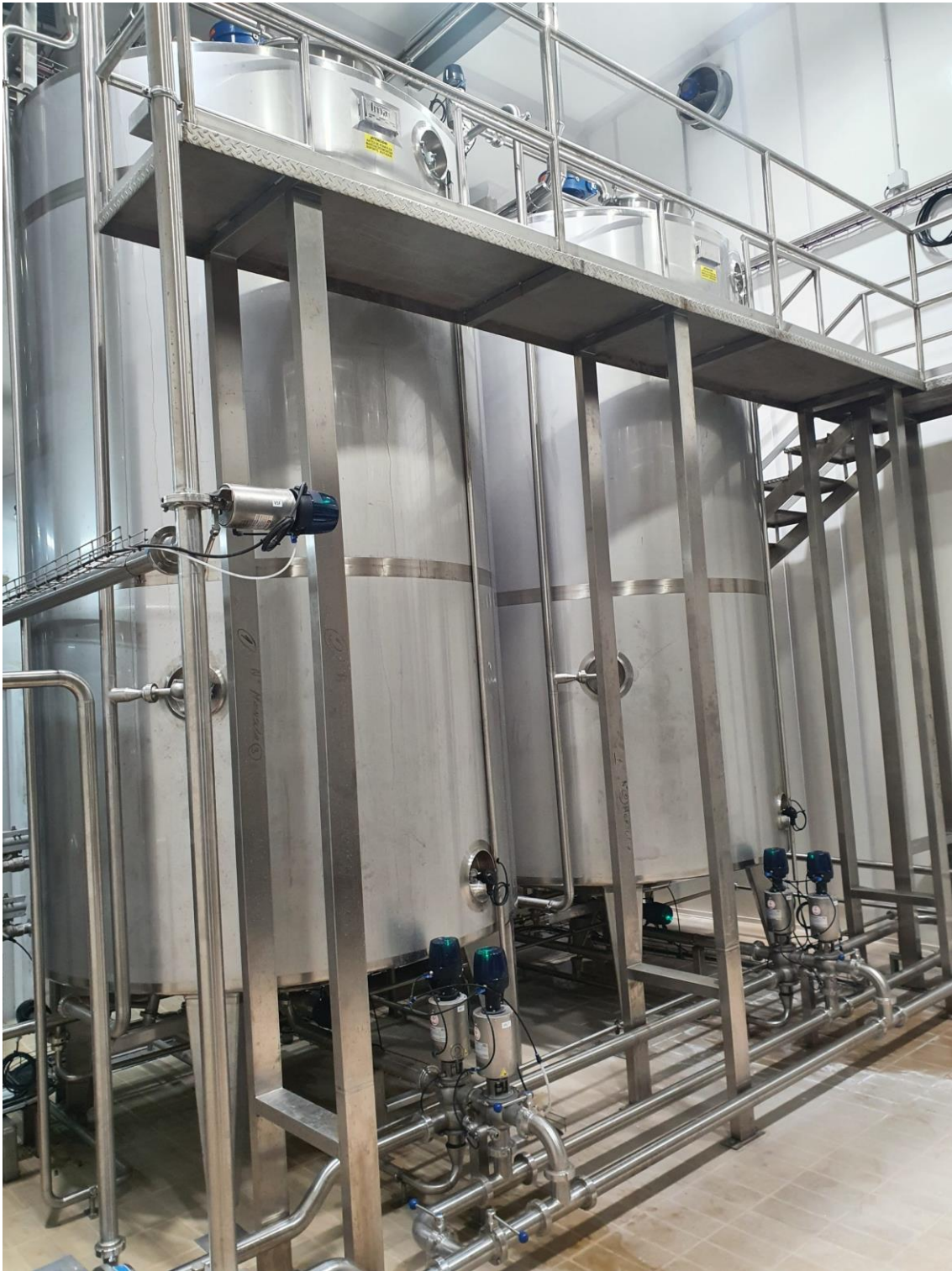
Tanque de yogur
