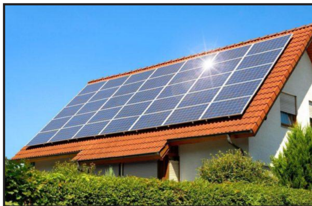
Paneles solares en viviendas.
