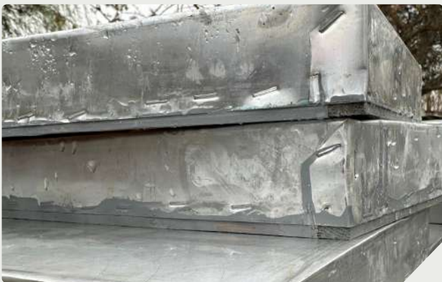
Tapa en chapa de aluminio (descarte de insumo de papeleras) engrampado y pintado para sellar posibles entradas de agua, muestra el reúso material como estrategia de resolución posible
