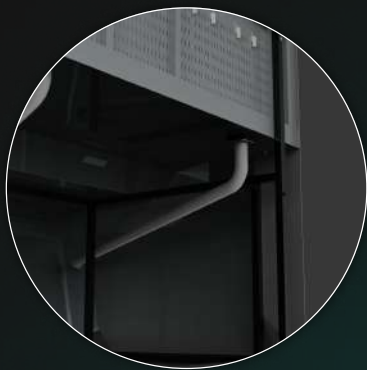
Conductos para entrada y salida de aire
